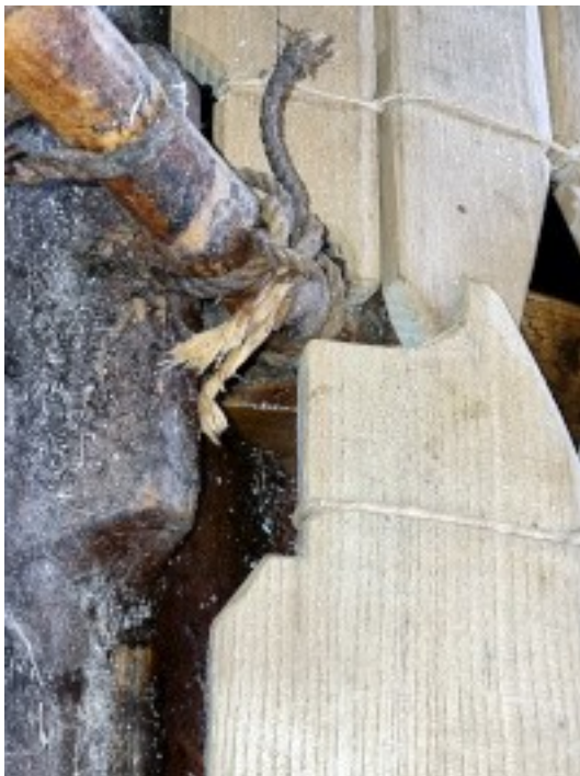
Fig. 4: Knust bastsnor mellem dæksbræt og -bjælke ved BB spant 3
