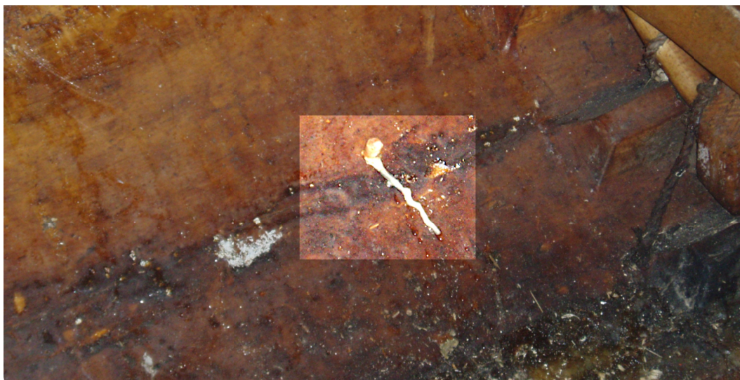
Fig. 17: En prop ved revnen, set indefra.
