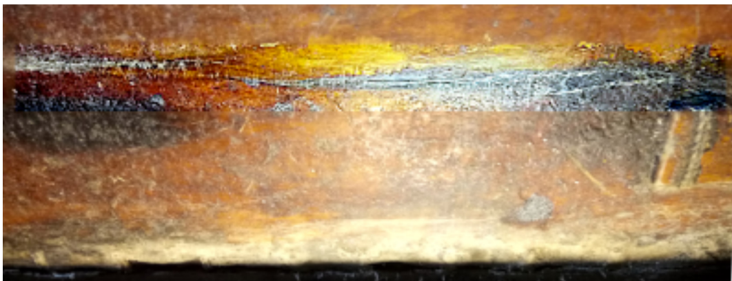
Fig. 11: Revne i sideplanken.
