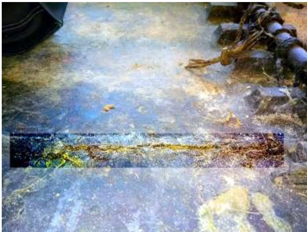
Fig. 2: Eksempel på revne ved syning i bunden (fremhævet).
