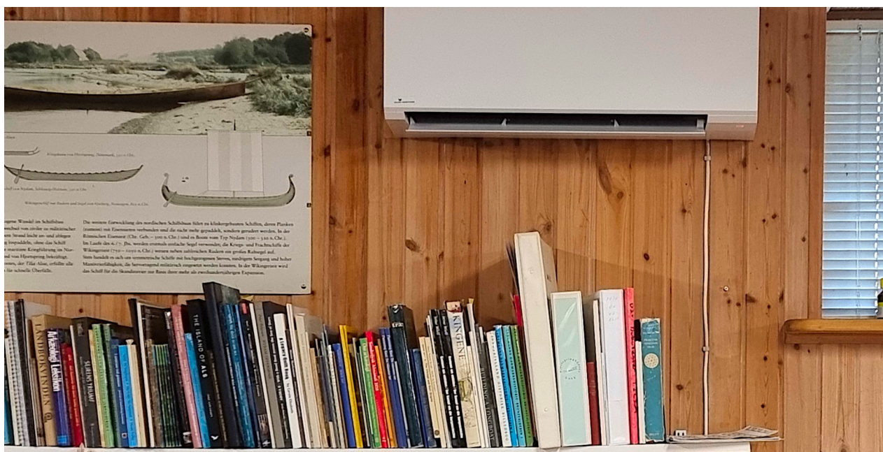
Fig. 2: Den nye varmepumpe.
